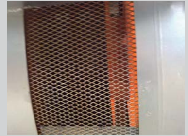
Aplicaciones en generador de calor
