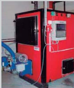
Aplicaciones en caldera
